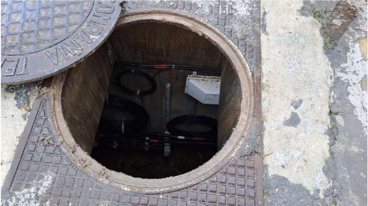
Imagen 7. Interior de los pozos de telecomunicaciones.
