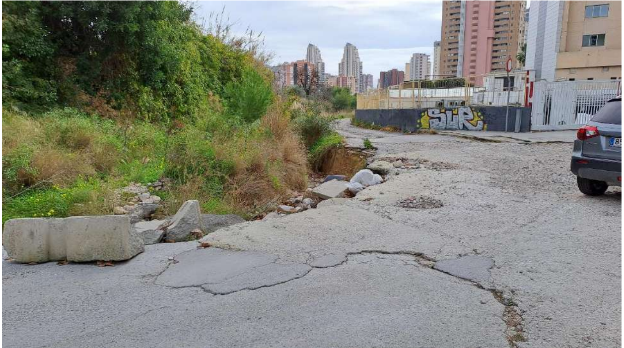
Imagen 53. Estado del cruce aguas abajo
